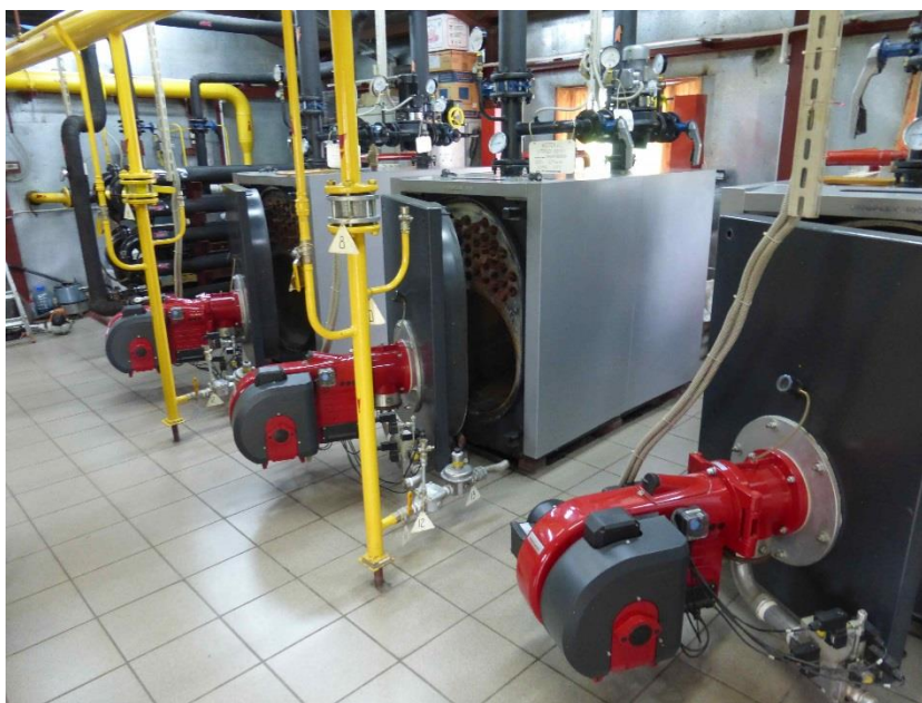
Рисунок 5 - Внешний вид основного оборудования котельной
