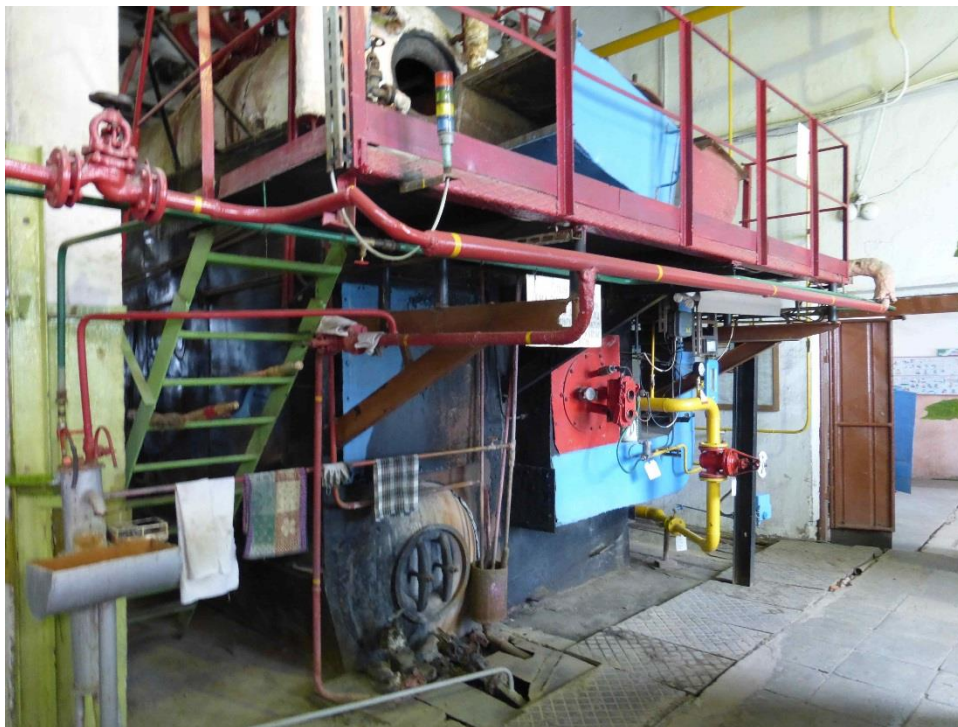
Рисунок 4 - Внешний вид основного оборудования котельной
