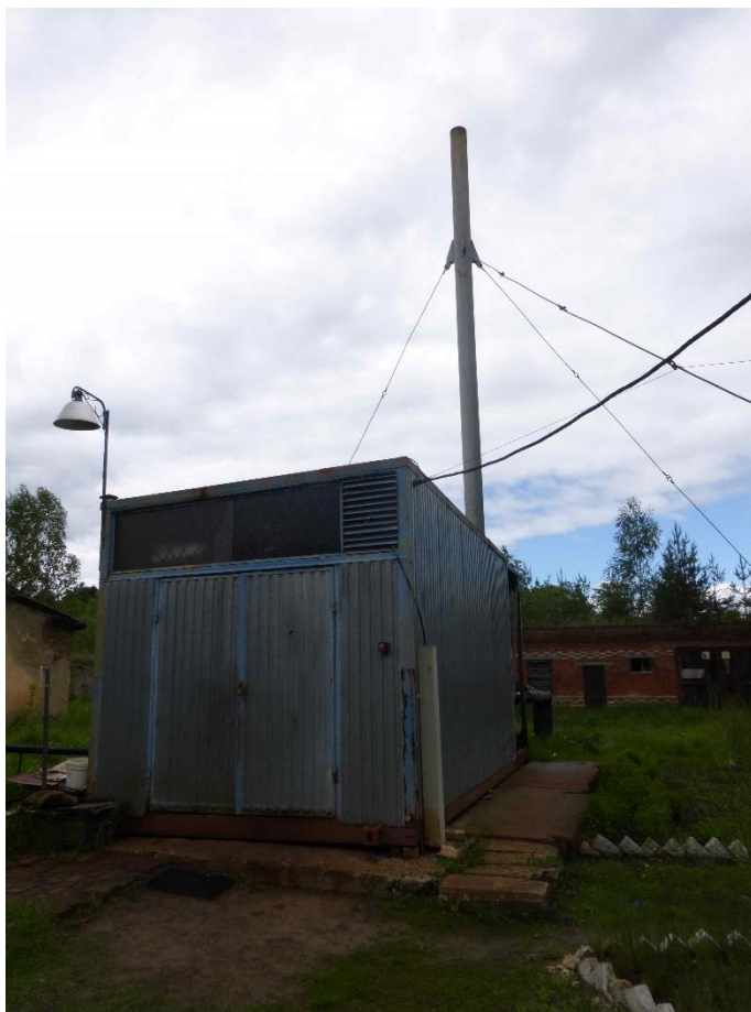
Рисунок 7 - Внешний вид котельной
