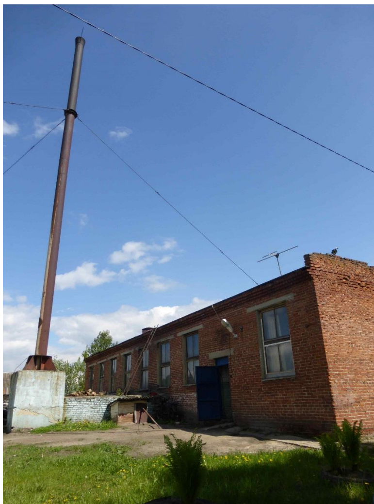
Рисунок 6 - Внешний вид котельной
