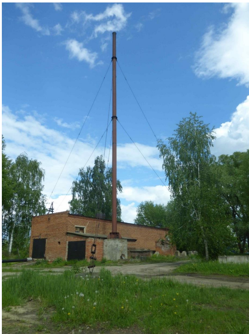
Рисунок 11 - Внешний вид котельной
